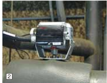
② 空調機の冷水コイル配管に導入された流量計測制御機能付電動二方弁ACTIVAL。制御弁、流量計、圧力計、温度計の4つの機能をオールインワンで持っているため、流量計測制御機能を実現する際に大きなコストダウンが可能。
