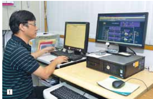
① 図書館棟の地下1階にある監視室に設置されたsavic-net FX(右)とEDS(左)。今回導入した空調設備の運転に関する監視・制御、およびエネルギー利用動向の確認が行えるようになっている。
