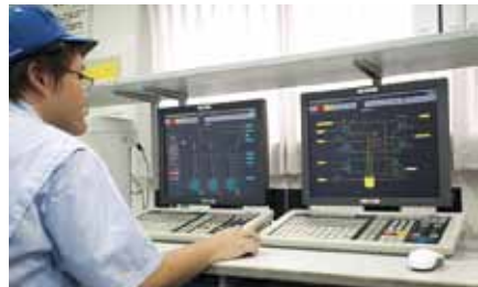
2階の監視室に設置されたHarmonas。1～4階に設置されたプラント内の各設備について監視・制御を行っている。
