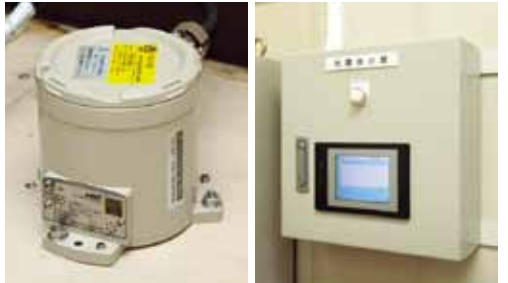
水島ガスでは、地震発生時の設備停止の判断基準用に、アズビルのインテリジェント地震センサ SES60も導入している。
