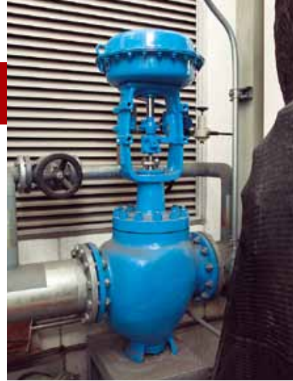
塗装工場側に新たに設置された調節弁。工場系統用エアと塗装工場用エアの製造量、使用量をHarmonasでモニタリングし、調節弁の開閉により工場系統にエアを供給するアズビルのプレッシャーバランス形調節弁 CV3000 Alphaplus™。
