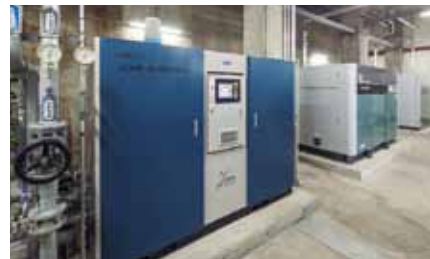
今回導入された工場系統用コンプレッサ。ターボコンプレッサ（140kW）、インバータスクルーコンプレッサ（160kW）、定速スクルーコンプレッサ（100kW）がそれぞれ1台、計3台となる。
