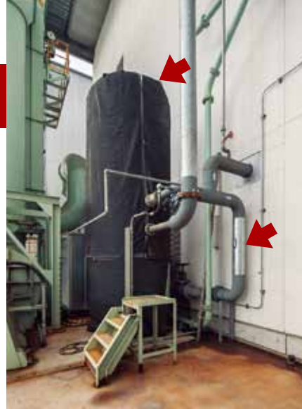
塗装工場側のエアタンク。手前に増設された配管が工場系統用エア配管と接続されており、エアの使用量に応じて融通することが可能となった。
