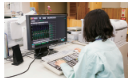
Harmonasは土佐町役場内の電算室に設置されているほか、事務所内にも端末が置かれ(写真)、こちらからも常時監視が行えるようになっている。
