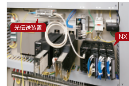
和田高区配水池に設置されている計装盤内。NXが光伝送装置を介して庁舎電算室にあるゲートウェイのDGPL IIにつながれ、中央監視システムに計測データを送っている。
