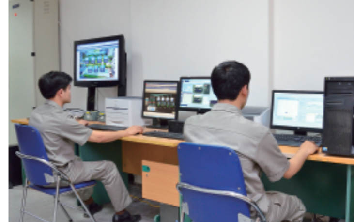
監視室に設置されたsavic-net FX。施設内の各種設備の監視がここで一元的に見えるようになっている。
