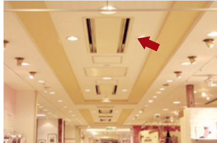
共用部通路に設置されているファンコイルユニット。手動バタフライ弁に電動モータを追加し、熱量計で計測している流量と温度から電動バタフライ弁を制御。適切な流量の冷水・温水を流すことで、ポンプの電力をはじめとするエネルギーを大幅に削減した。
