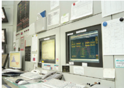
ゆめおおおかに中央監視システム(BEMS)として導入されているアズビルの建物管理システム savic-net TM FX(手前)とビルマネジメントシステムsavic-net FX BMS(中央・奥)。
