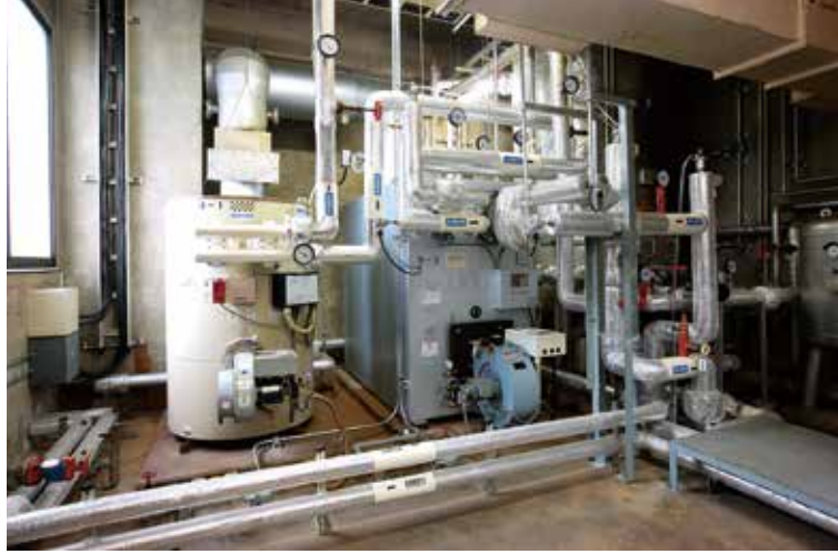
今回導入した高効率ボイラ(右)と旧来の重油焚きボイラ(左)。重油焚きボイラは、ヒートポンプ給湯器が故障したり、お湯の要求量が能力を超えた場合の追従運転用となっている。
