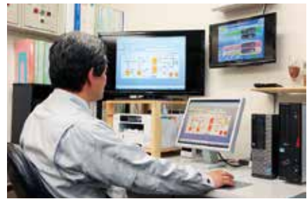
事務所に置かれた中央監視システム savic-net FX mini。設備管理担当者のほか、フロントのスタッフも日常的に操作する。
