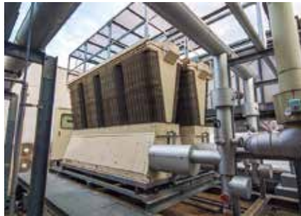
工場屋上に置かれた空冷ヒートポンプチャラー。今回の施策で最新の高効率機にリプレースされた。
