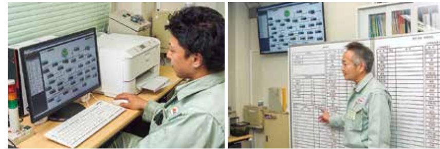
本社に設置された遠隔監視／遮断システム。画面上には32カ所の地区ガバナと6カ所の地震センサの状態に加え、ガス圧力、ガス漏れ発生の有無などが併せて表示される（左）。また、執務室内には大型ディスプレイも設置されており、有事の際には、大型ディスプレイに表示される情報と併せて、あらかじめ用意されているホワイトボードで刻々と変わる状況を記録し、災害および保安点検状況を社員が共有できる形となっている（右）。
