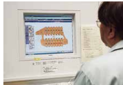
中央監視室に設置されたsavic-net FX2 セキュリティの監視画面。アズビルのBOSSセンターに接続され、遠隔監視も併せて行われている。
