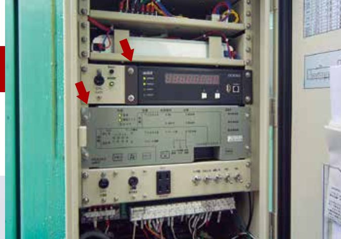
地区ガバナに設置されたFOMA対応遠隔データコレクタ DCX350と遮断制御ユニットSES51Z。
