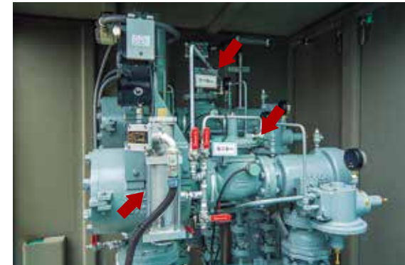
緊急遮断弁SSVは二重化システムとなっており、通常はメイン側が動作しているが、故障時などはサブ側がバックアップを行う。銀色の筒状の機器は負圧ユニット。緊急遮断弁SSVと組み合わせることにより外部電気信号による遮断が可能となる。
