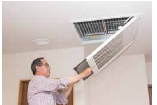
天井に配置された電子式エアクリーナ。日常的なフィルタ清掃はこの1カ所の開閉グリルを開いて中のフィルタ表面のホコリを掃除機で吸い出すのみ。
