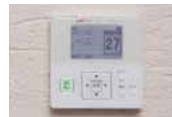
2階に設置された全館空調システムのリモートコントローラ。夏は冷房の27℃、28℃、冬は暖房の22℃、23℃に設定し、一定の温度に保っているという。
