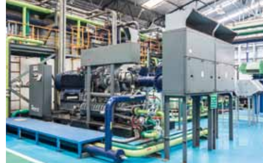
SKICのWangsala工場全体にエアを供給するコンプレッサ群。
