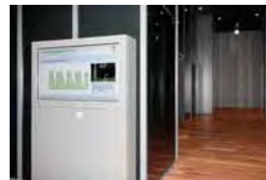
オフィスエントランスに設置されたデジタルサイネージ。クラウド上のエネルギーデータを活用して、ビル全体の電力利用概況や省エネ効果などを入居者に分かりやすいグラフで表示し、省エネ意識を喚起している。
