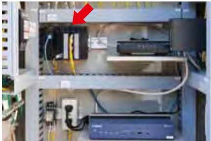
熊山取水口の伝送装置盤内に設置された計装ネットワークモジュールNX。水位監視・雨量観測の情報をWeb経由でデータセンターに送っている。
