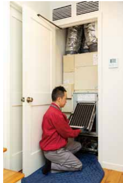
「きくばり」の特長の一つである電子式エアクリーナの状態を点検し、異常の有無を確認する。
