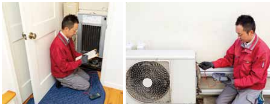
室内機(左)、室外機(右)で、電圧・電流など電気系統の点検などを行う。
