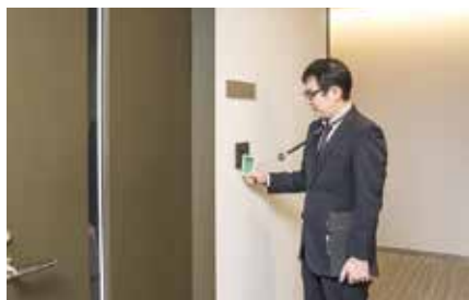
各テナント入り口に設置された非接触ICカードリーダ。
