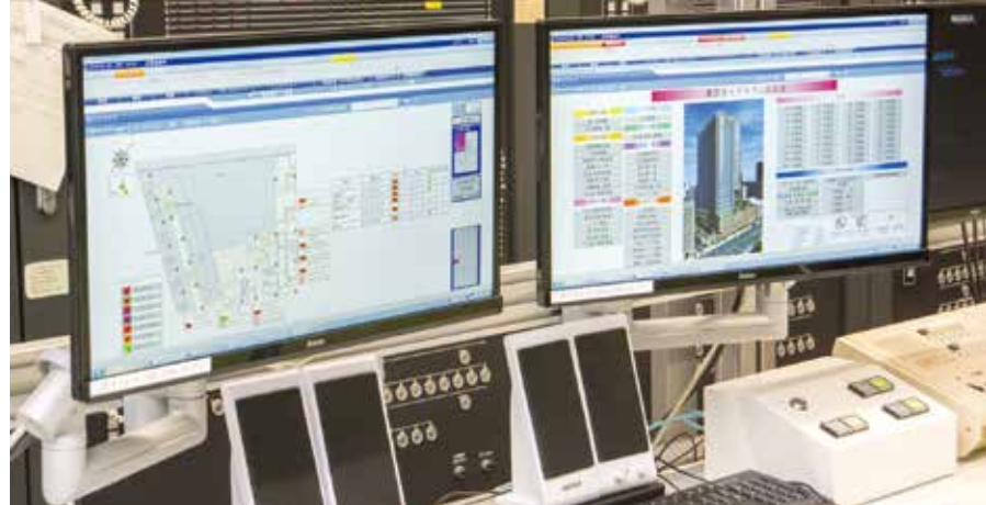
中央監視室でビル全体のセキュリティ状況や、空調などの設備運用状況を一括で監視することができる統合型建物管理システム savic-net FX2 セキュリティの操作画面。
