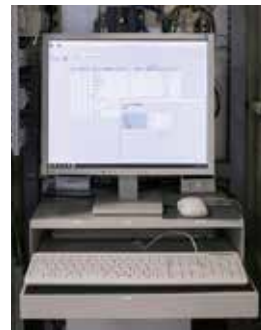
空調制御盤内に設置されているsavic-net FX mini。
