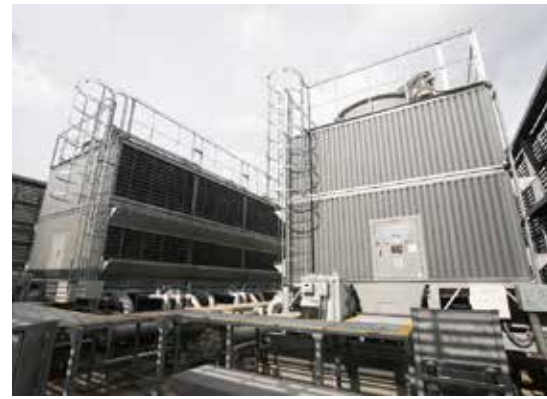
屋上に設置された冷凍・冷蔵庫用の冷却塔。
