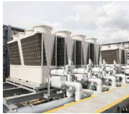
空調用熱源機（空冷式ヒートポンプチャラー）。ユニット（冗長）化されているので、故障が起きた際もバックアップ運転が可能となり、省エネルギーに加えて大きな安心感を得られている。
