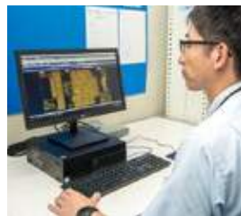
富士勝山工場内の空調設備を一元管理しているsavic-net FX。この画面から富士吉田工場、鳴沢工場の運用状況も確認・操作ができる。
