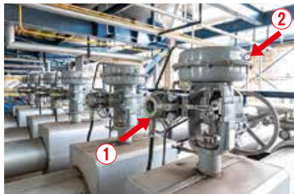
スマート・バルブ・ポジションナ 700シリーズ (①)を搭載したブレッチャバランス形ケーシング調節弁 (②)。石油化学製品の原料と併せて投入される蒸気の流量を制御している。
