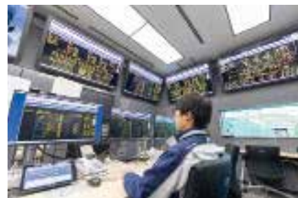
中央監視室に設置されたsavic-net FX2 セキュリティのモニタ画面(上)と建物設備管理を行っている建物管理システム savic-net FX2。
