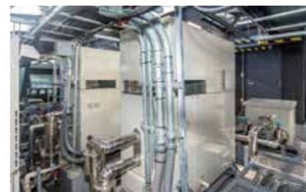
設備の運転データを解析することで運転時間の見直しを行い電力量削減につながったコージェネレーションシステム。施設の屋上に設備が設置されている。
