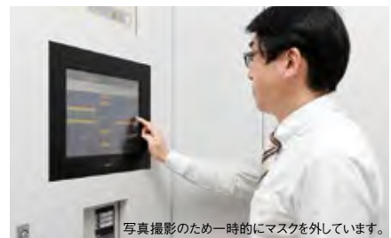
写真撮影のため一時的にマスクを外しています。 新本庁舎の設備を集中管理しているsavic-netFX2compact。収集したデータをアズビルのデータウェアセンターに送信し、新本庁舎設備の運用状況の確認および運用改善施策の立案に役立てられている。
