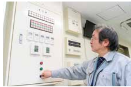
多用途型トリアージ施設に設置された操作盤。スイッチ一つで通常モード／陰圧モードの切替えができる。
