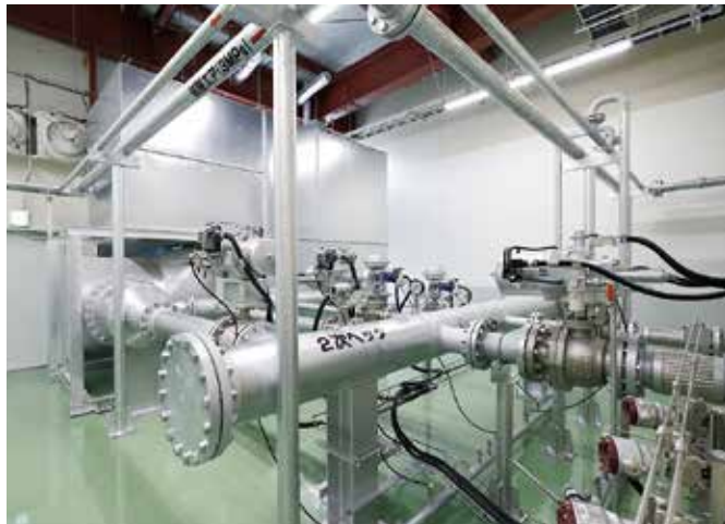
大流量の空気をそのまま屋外へ排気することを避けるため、消音装置を通し、減速させてから屋外に排気する。
