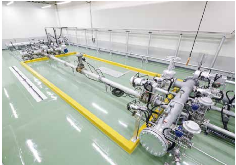
水用流量試験設備（試験エリア）。口径に合わせて対応する配管に試験対象のバルブを設置して試験を行う。
