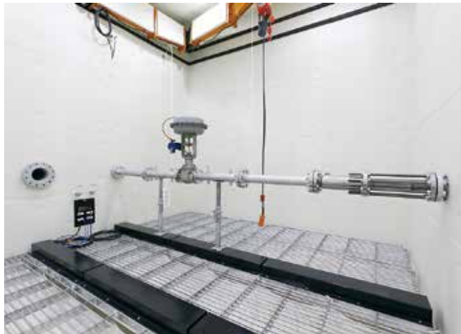
空気用流量試験設備（流体騒音計測用無響室）。無響室内にバルブを設置して試験を行うことで、空気が流れたときの騒音特性の計測も可能。
