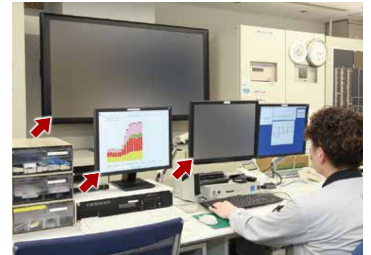
中央監視室に設置されたsavic-net FX(手前中)の空調平面図と、savic-net FXビルマネジメントシステム(BMS)(手前左)の電力量グラフを表示したモニタ画面。savic-net FXでは、空調の制御状態を監視しており、BMSでは、機器の台帳管理やエネルギー管理を行っている。大型モニタでは、設備管理員で共有したい情報などを映し出すことができる。
