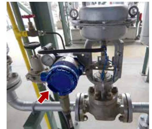
バルブに取り付けられているスマート・バルブ・ポジションとIFOとの間でHART通信を行い現場機器の稼働状況を可視化している。
