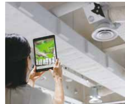
カフェエリアの空調吹出口からは、どれくらいの温度、どれくらいの風量で風が出ているのかをARで視覚的に見ることが出来る。
