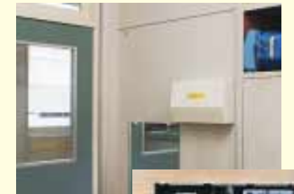
各教室に設置された教室コントローラ。右はその内部
