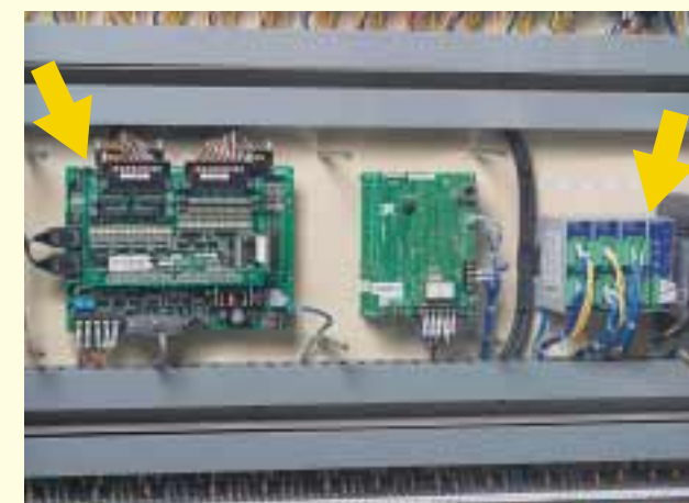
温室ごとに設置された制御盤内のMX50(左)とDMC10
