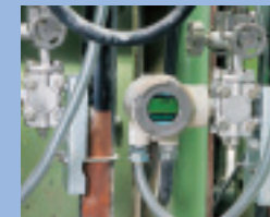
炉に送り込む酸素の流量を計測する温圧補正形差圧発信器
