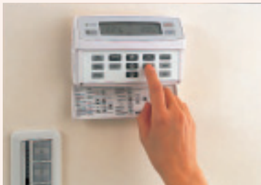
セントラル空調システム「きくばり」を導入した高気密・高断熱住宅（写真上）と湿度、温度、換気をコントロールするコンフォートセンタ（写真下）
