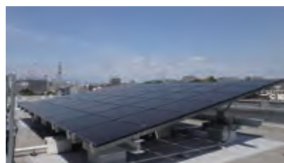
太陽光発電設備
