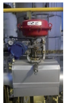
調節弁稼働データはクラウドへ送信され、CBMによる調節弁の整備計画策定を行う
