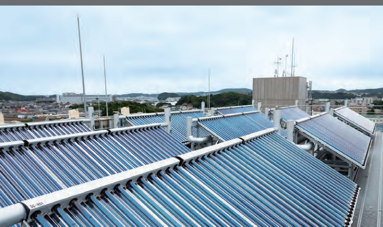
●第103建物屋上に設置された太陽熱エネルギー設備
