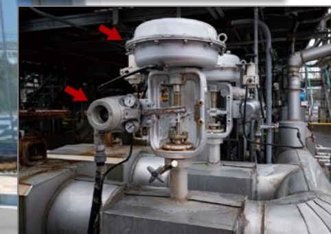
スマート・バルブ・ポジショナ 700シリーズ（左）を実装したアズビルのトップガイド型単座調節弁。熱溶解した原料を加温するために加熱炉に送り込まれる蒸気の流量を制御している。
